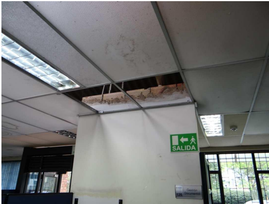
Figura 4: Detalle típico que muestra cómo los muros de mampostería están completamente libres en su extremo superior, lo cual implica serio peligro.
