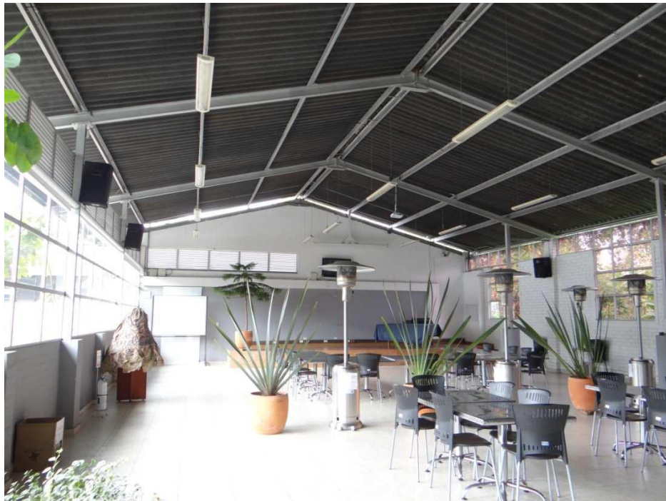
Figura 2: Estructura característica de las cubiertas en la cual se comprueba absoluta falta de conformación del diafragma para efectos sísmicos.
