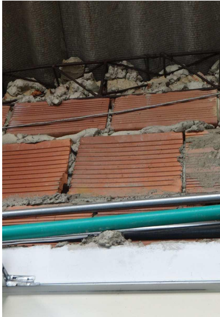
Figura 3: Muestra de la deficiencia constructiva de muchos de los muros existentes.
